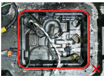
Unitate de comandă deteriorată sau lipsă
